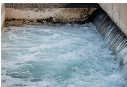
Traitement des eaux
